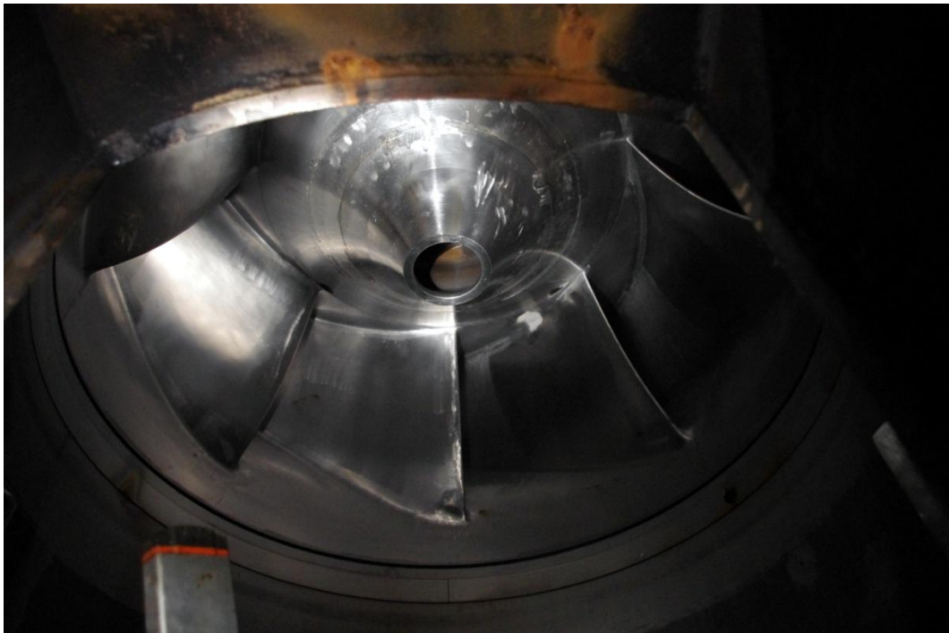
Příloha č. 17 - Pohled na oběžné kolo reverzní turbíny skrz otevřené dolní víko.
