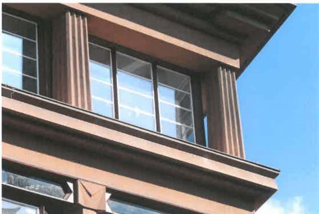
Obr. č. 20 – Detail třetího patra – mezery mezi sloupky a okny.
