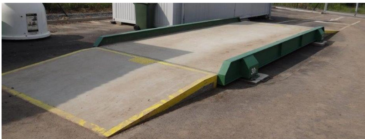
Obrázek 12 - Mostová váha na sběrném dvoře v Třeboni (Zdroj: Vlastní)
