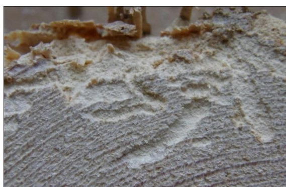
Obrázek č. 14 – požerky tesaříka krovového
