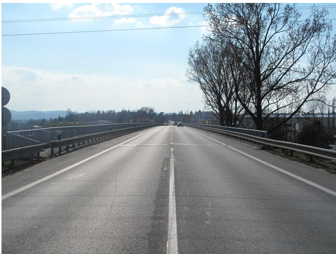
Obr. 2: Pohled na most ev. č. 4 – 043 vedený ve směru jízdy od Prahy do centra města Strakonice
