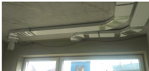
Obr. č. 16 - rozvod rekuperace (foto autor)
