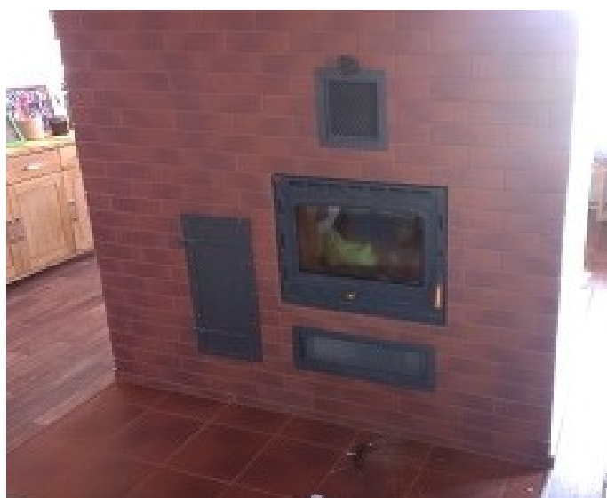
Obr. č. 21 - krb na vytápění domu a TUV (foto autor)
