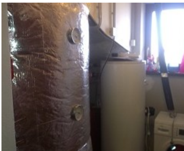
Obr. č. 22 – 250 l bojler a 1 000 litrový zásobník na TUV (foto autor)
