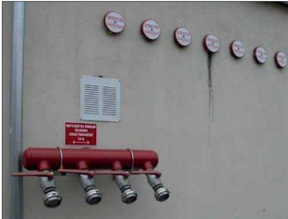
Obrázek 27: Poplachové zvony a armatura pro připojení CAS
