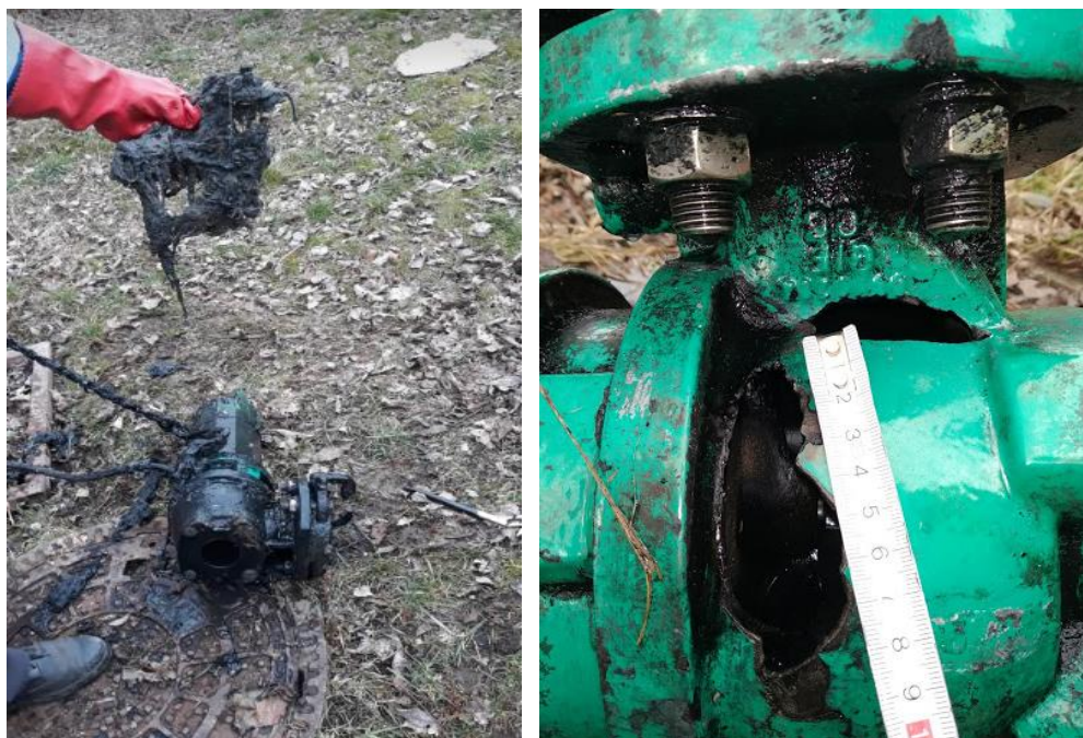
Obrázek 15: Čerpací stanice tlakové kanalizace na jednotné síti – havárie čerpadla, vlevo ucpání čerpadla pevnými částicemi, vpravo proražení komory oběžného kola kamenem.
