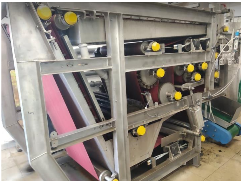
Obrázek 27: Sítopásový lis instalovaný na ČOV Cerhovice.
