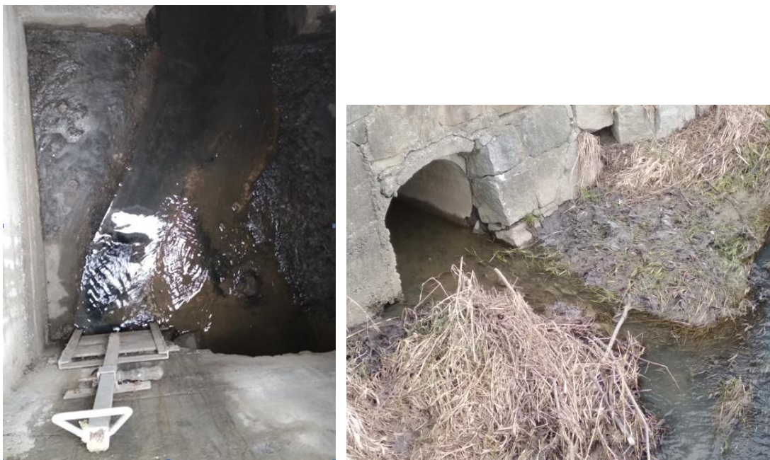
Obrázek 17: Odlehčovací komora OK 12 – závadný stav při tání sněhu – voda natéká odlehčovací stokou do sběrače.
