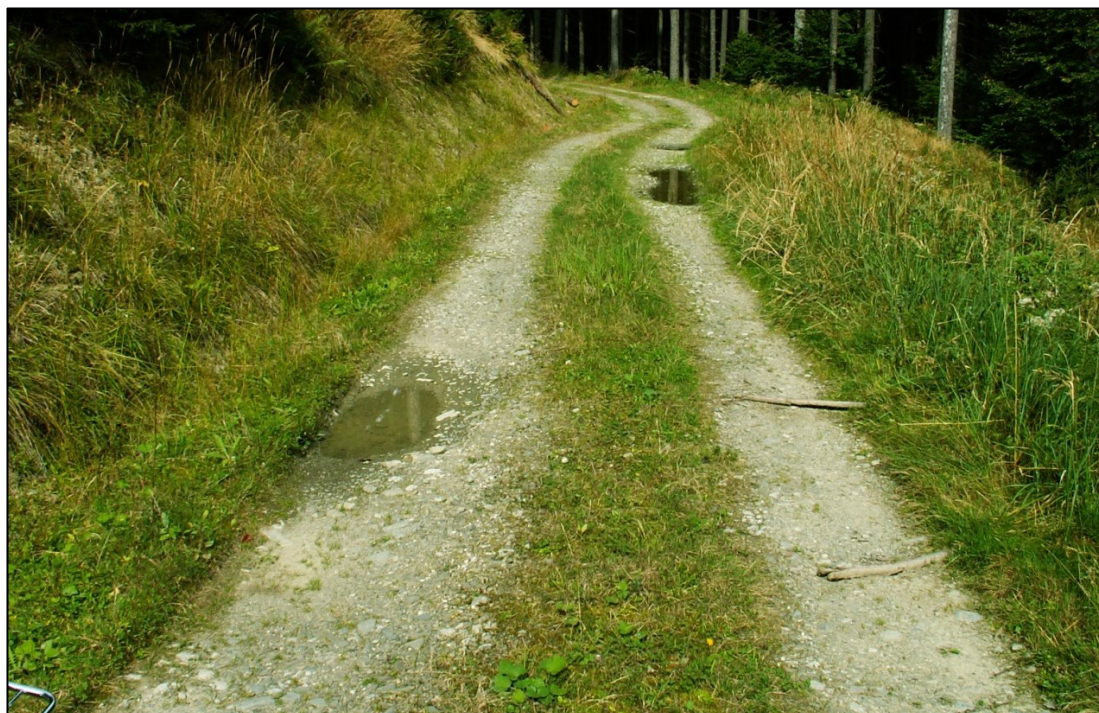
Foto 5. Odvozní cesta se šterkovým povrchem (třída porušenosti 2), úsek s jámami a vytlačenými okraji (autor 2012).
