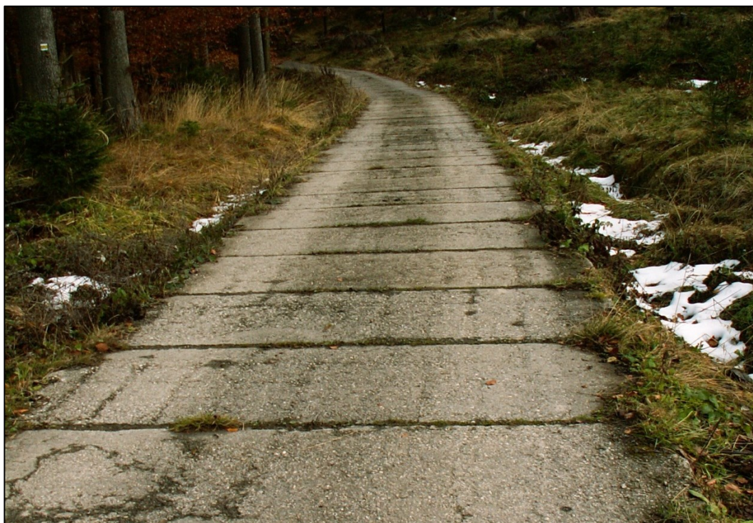
Foto 4. Odvozní cesta třídy 1L s panelovým povrchem, třída porušenosti 2 (autor 2011)
