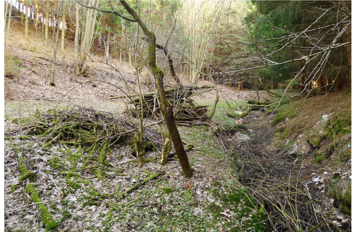
Obr. 71 Pohled ze spodu na cestu, trubku a erodované koryto pod ní
