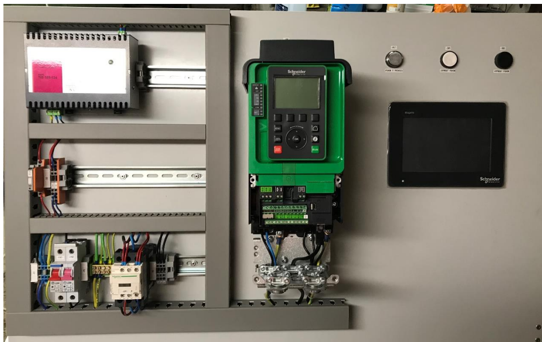
Obr. 29 Foto sestavy elektrického pohonu před oživením úlohy
