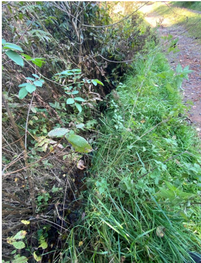
Obr. č. 49 – drobná vodoteč se špatným technickým stavem; vlastní foto dne 28. 9. 2021
