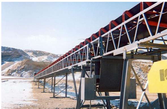
Obrázek 13 Nosná konstrukce pásového dopravníku [30]
