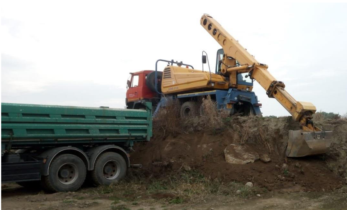
Obrázek 12 Činnost rýpání a nabírání horniny během měření časů pracovních cyklů – ve stavu před provedenou inovací hydraulického systému rypadla UDS 214
