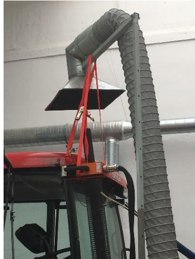
Obr. 13 Zařízení pro odsávání spalin z výfukového potrubí.
