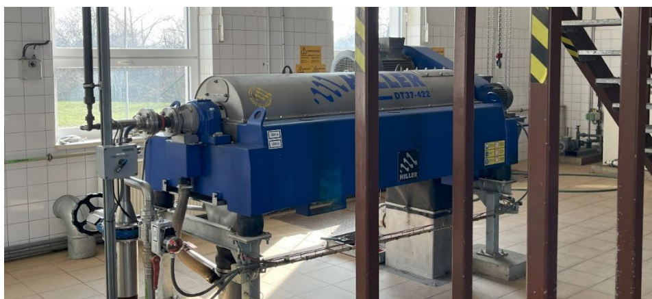
Obr: 18: Odvodňovací odstředivka ve strojovně ČOV Litvínov (zdroj: autor).
