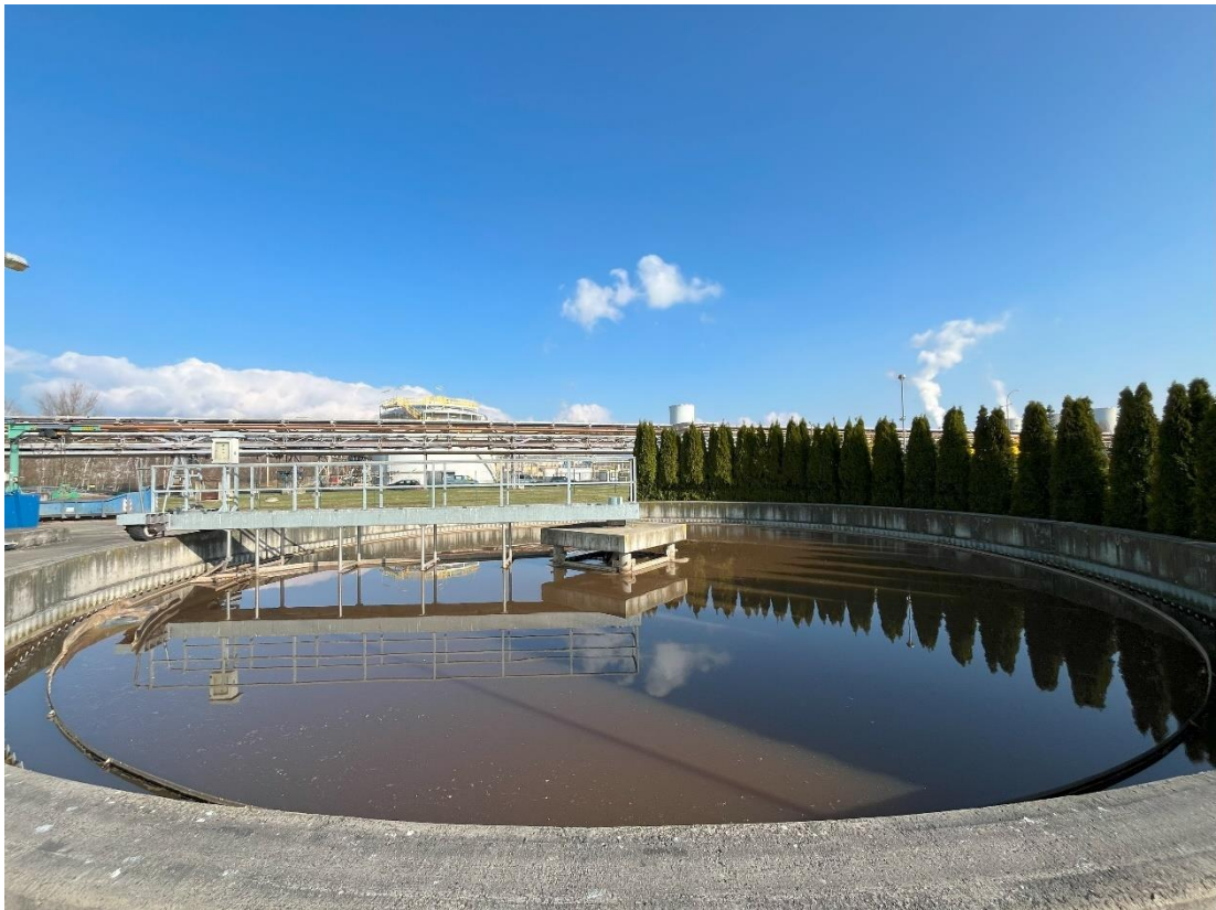
Příloha 6: Usazovací nádrž (zdroj: autor).
