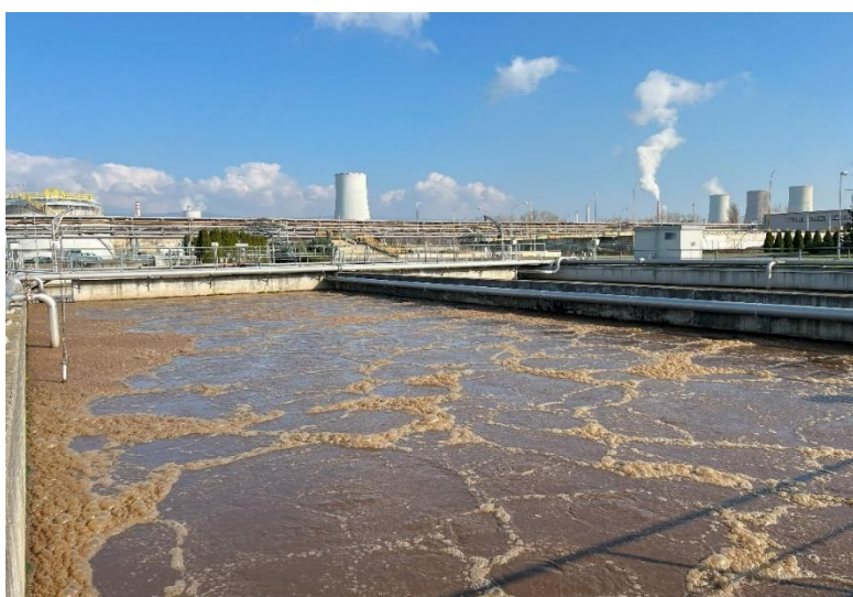
Obr. 16: Nitrifikační nádrže ČOV Litvínov (zdroj: autor).
