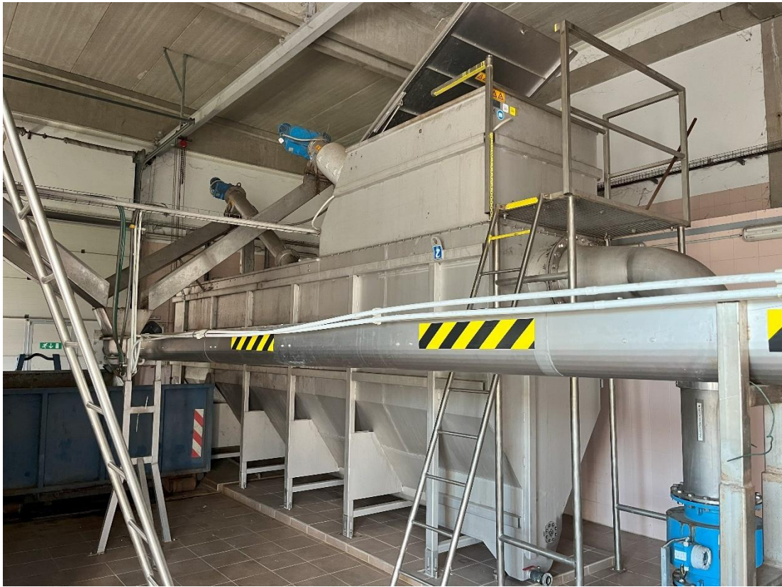
Příloha 5: Integrované hrubé předčištění (zdroj: autor).
