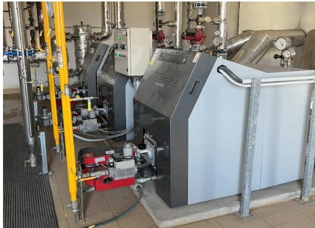
Obr: 20: Kotelna (zdroj: autor).
