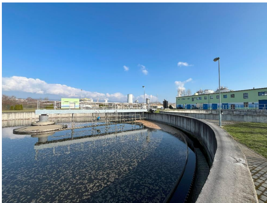
Obr. 17: Dosazovací nádrž ČOV Litvínov (zdroj: autor).
