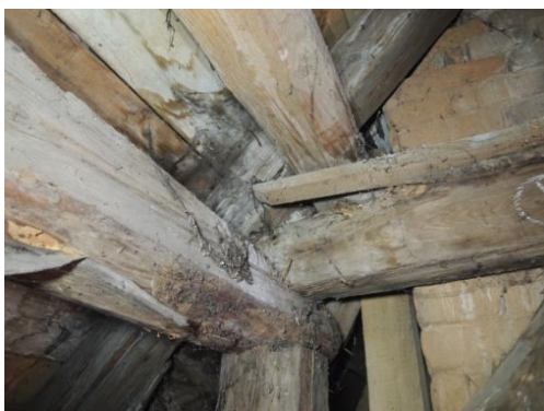
Obr. 36: Poškozený hambalek v první vazbě
