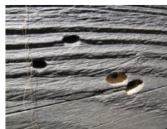
Obr. 23: Hylotrupes bajulus – oválné výletové otvory (thermosanace.cz)
