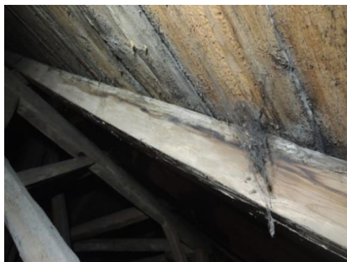
Obr. 40: Západní krokve 7. vazby poškozená hnilobou a tresářikem
