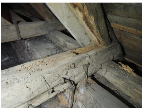
Obr. 38: Spoj VT a krokve poškozený biotickými škůdci
