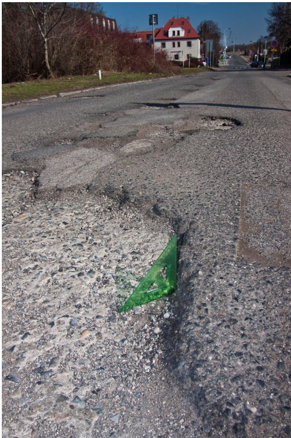
Příloha č. 4 - Obr. 6 – Výtluk – výsledek dlouhodobého zanedbávání údržby
