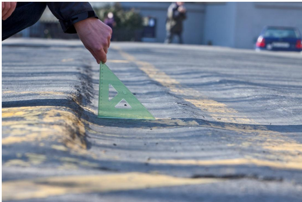
Příloha č. 6 - Obr. 8 – Vyjeté kolej – vyjeté koleje způsobené autobusy MHD
