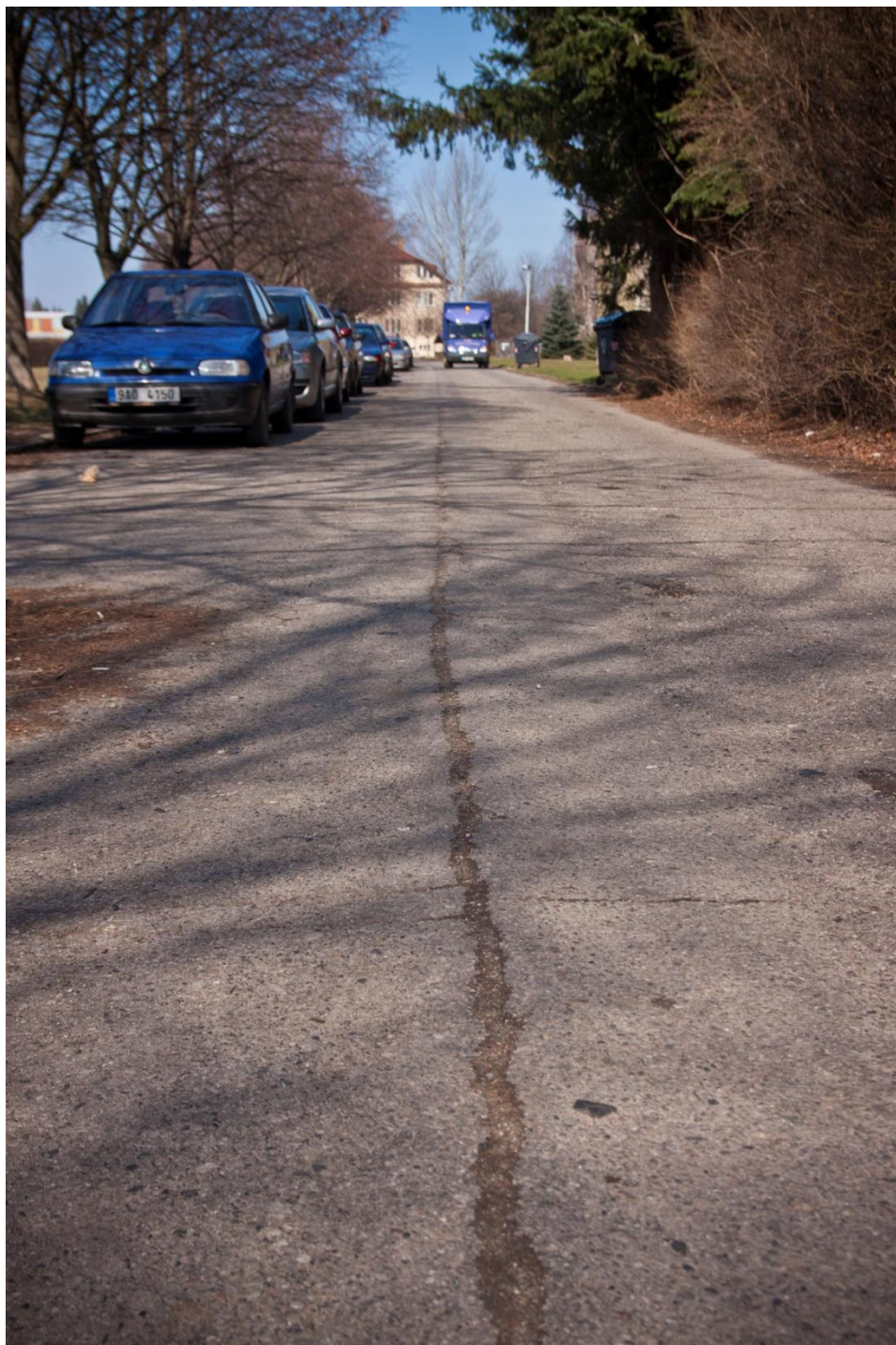
Příloha č. 2 - Obr. 4 - Podélná trhлина
