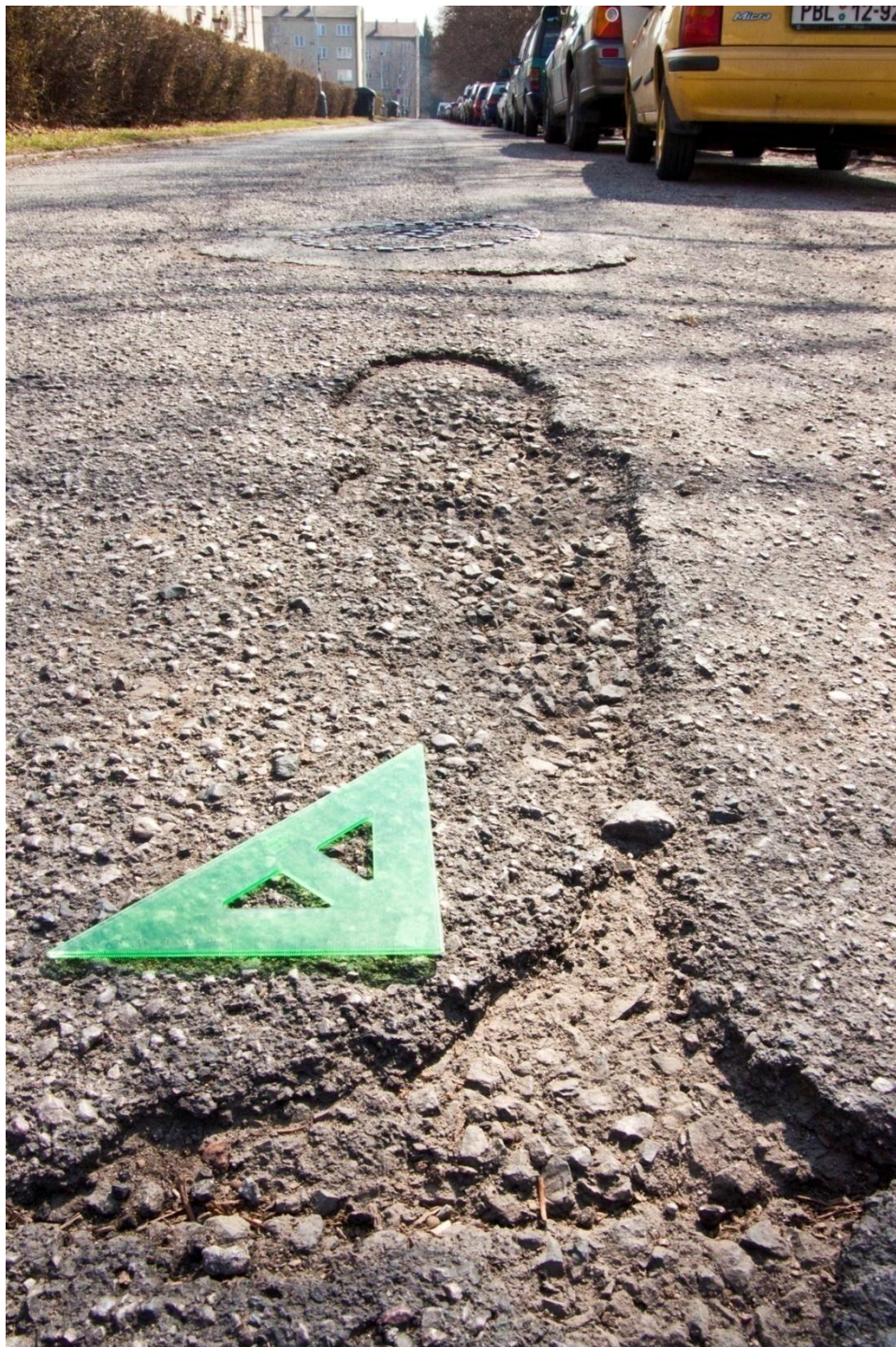
Příloha č. 5 - Obr. 7 – Porušení krytu vozovky vlivem povětrnosti
