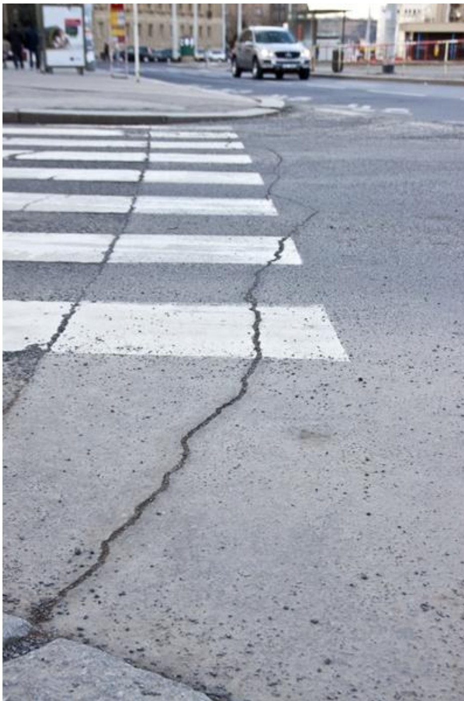
Příloha č. 3 - Obr. 5 – Příčná trhлина
