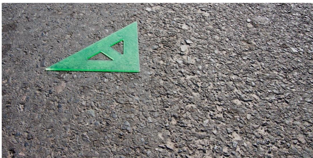
Příloha č. 7 - Obr. 9 – Ztráta drsnosti - vlevo pojížděná část vozovky (ztráta drsnosti), vpravo nepojížděná část vozovky (původní drsnost)
