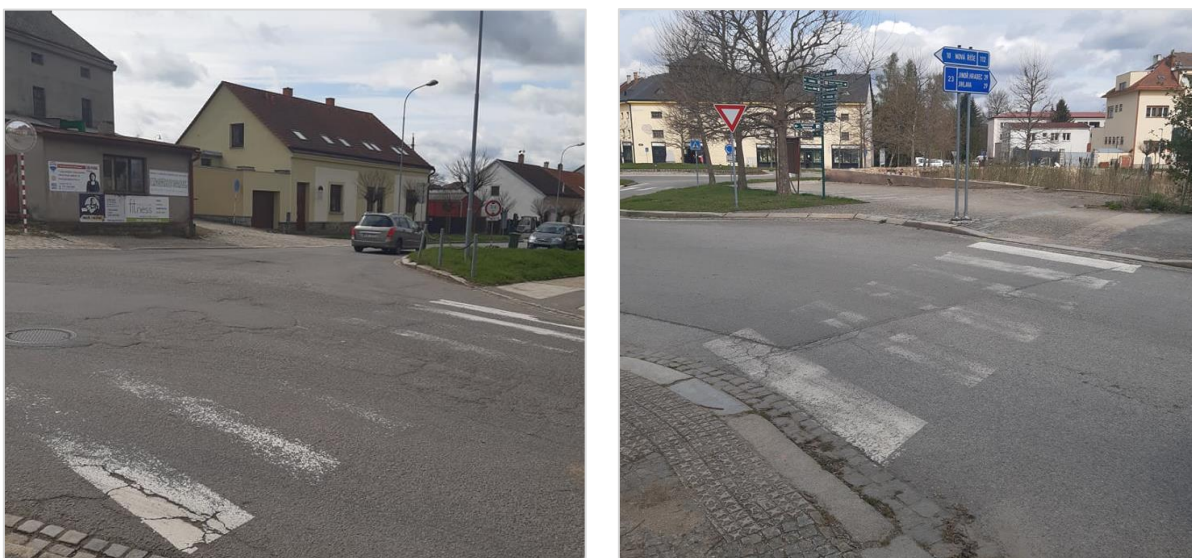
Obrázek 29 Nevyhovující vodorovné dopravní značení V7a [Zdroj: vlastní]
