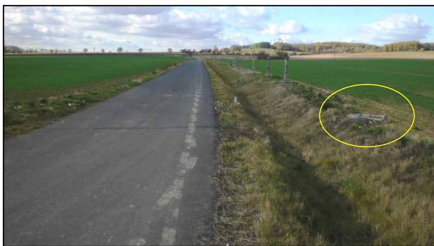
Obr. 43: Vedlejší polní cesta C 15 s vyvráceným stromkem
