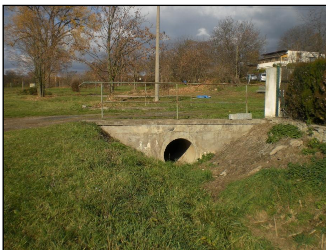
Obr. 35: Současný stav opevnění koryta potoka „Baba“
