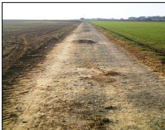
Obr. 24: Narušený povrch vedlejší polní cesty C1
