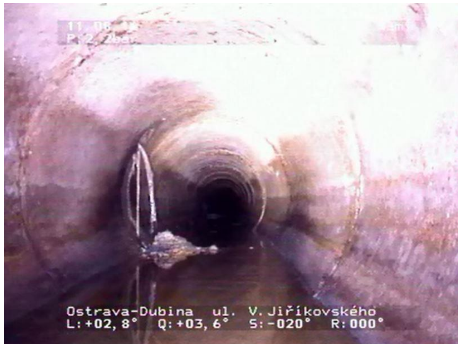
Obr. 45 Fotografie z kamerového průzkumu [OVAK a.s.]
