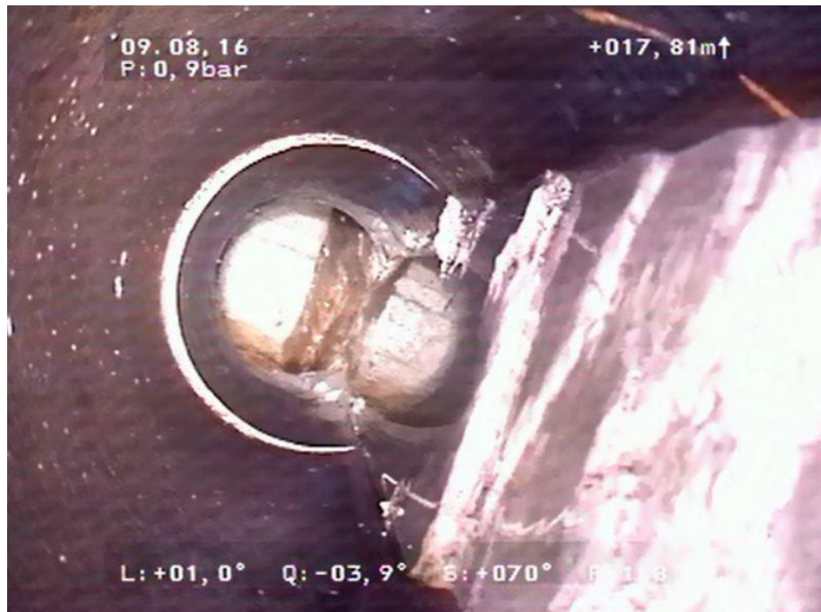
Obr. 31 Fotografie z kamerového průzkumu [OVAK a.s.]
