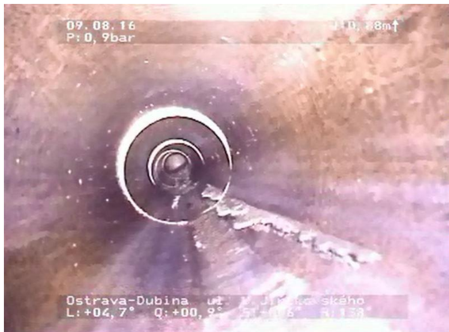
Obr. 30 Fotografie z kamerového průzkumu [OVAK a.s.]
