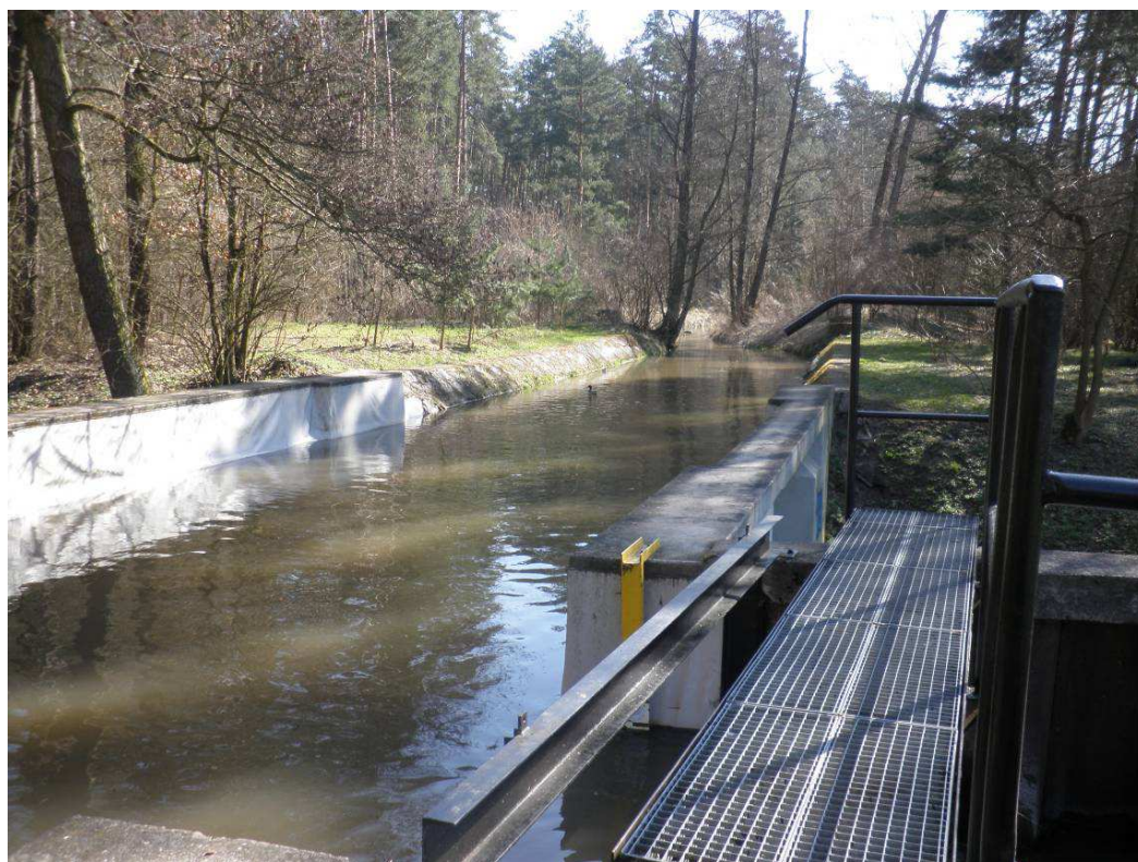
Obr. č. 17 pohled na Opatovický kanál nad akvaduktem v Semíně (foto: autor, 2013)
