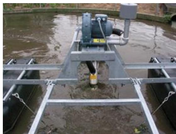
Obr. 3. – Povrchový aerátor na plovoucím zařízení [7]
