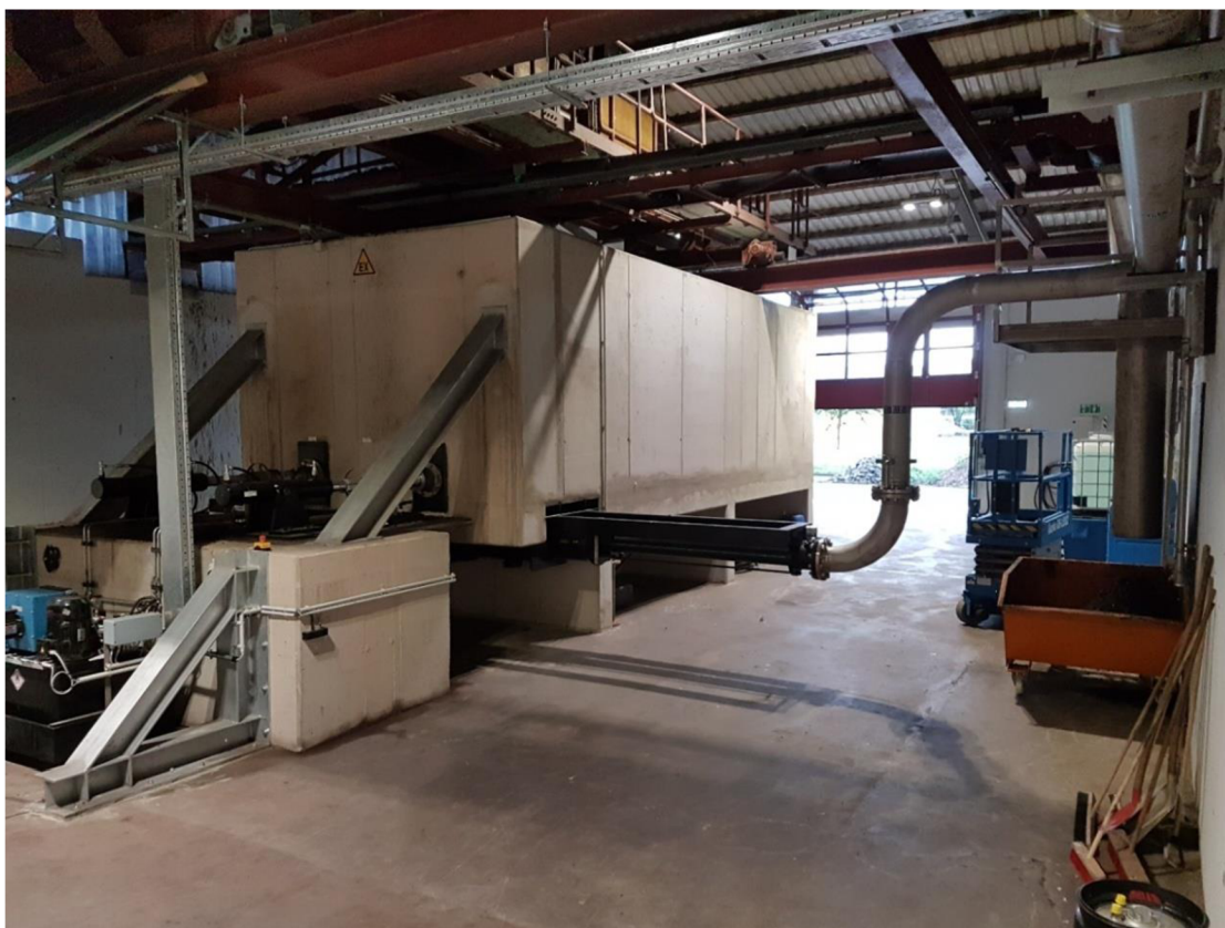
Obr. 15: Betonový bunkr na odvodněný kal s hydraulickou jednotkou a čerpadlem kalu
