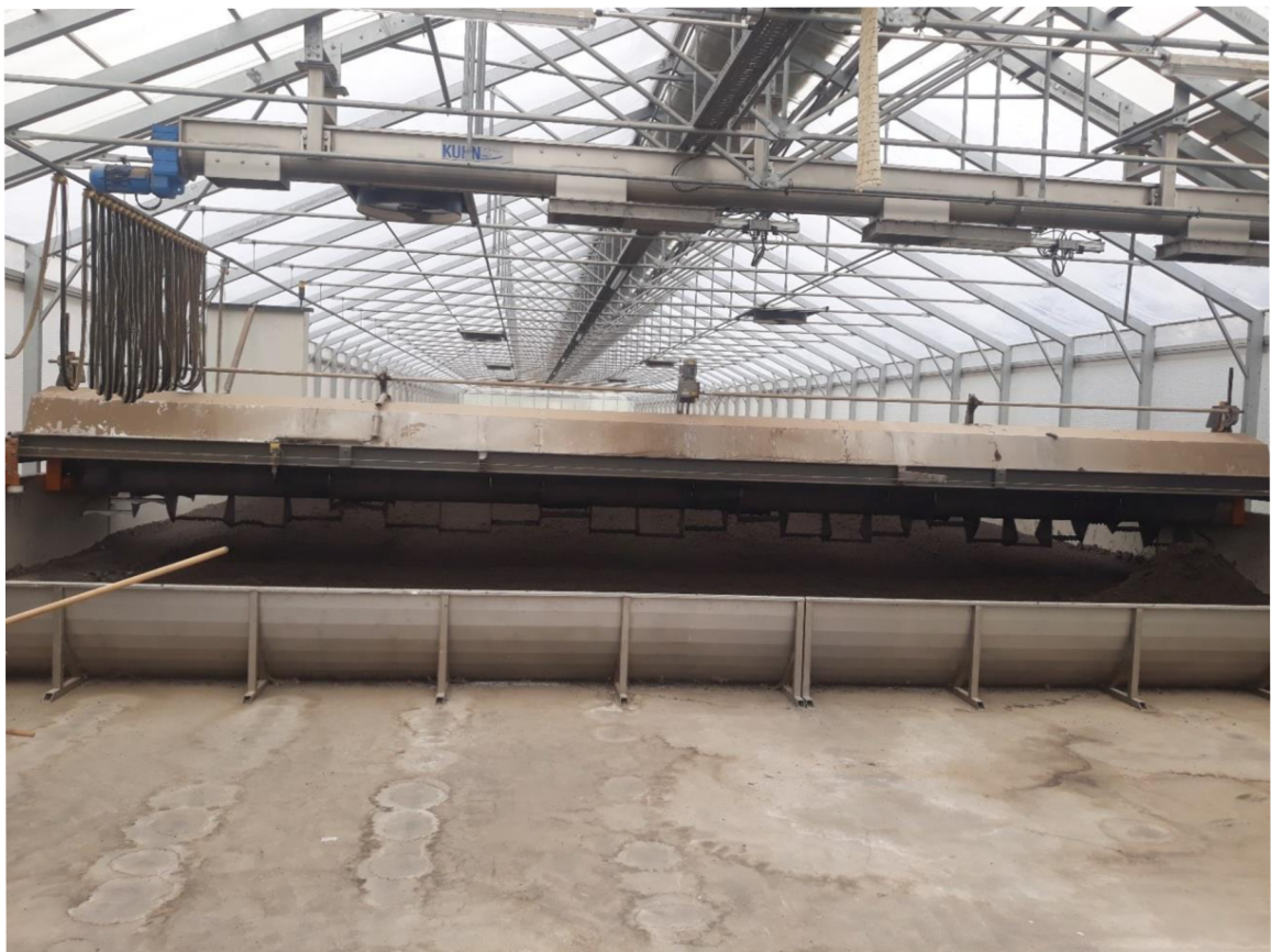
Obr. 18: Vnitřní prostor solární sušárny s přeřabovacím zařízením
