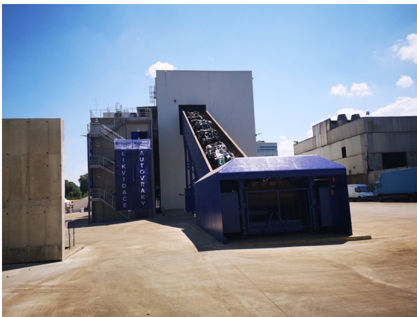
Obrázek 10 - Pohled na drtič se vstupním odpadem 131
