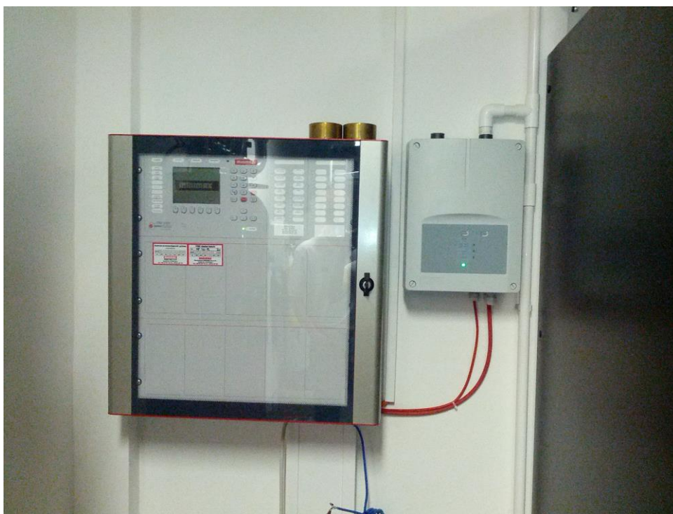
Fotografie 2: Ústředna požární signalizace a hasícího zařízení
