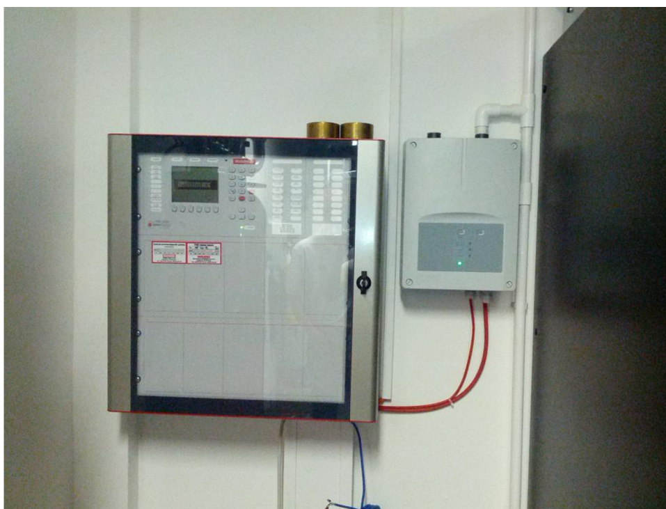
Fotografie 2: Ústředna požární signalizace a hasícího zařízení
