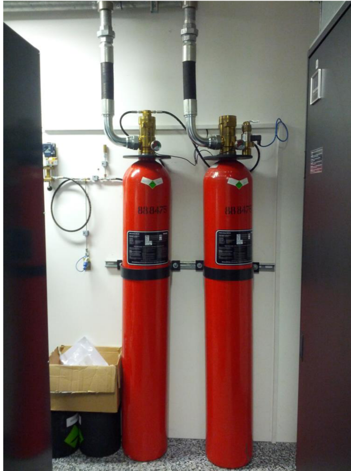
Fotografie 3: Hasící zařízení
