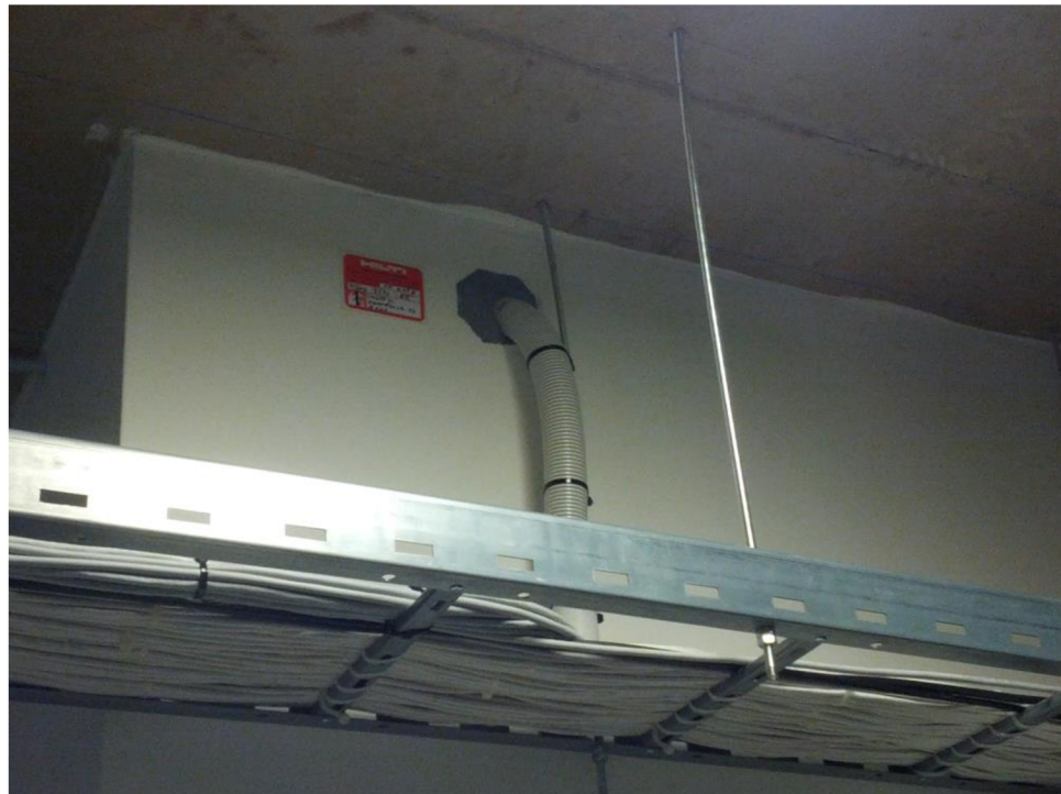
Fotografie 4: Odvětrávací šachta
