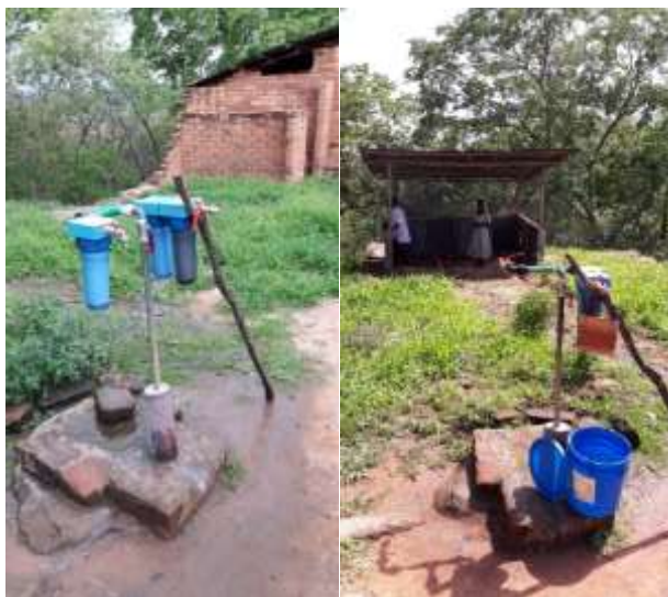
Obrázek 78 – nainstalované vodní filtry obsahující nanovlákněné membrány
