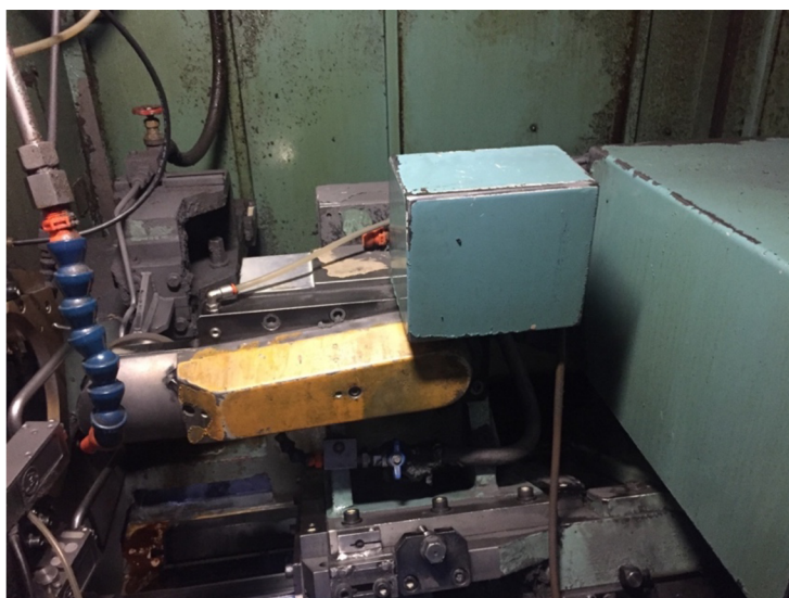
Obrázek 33 Řemenová fortuna na jednom ze strojů výroby. Řemenový převod je uvnitř plechových krytů.
