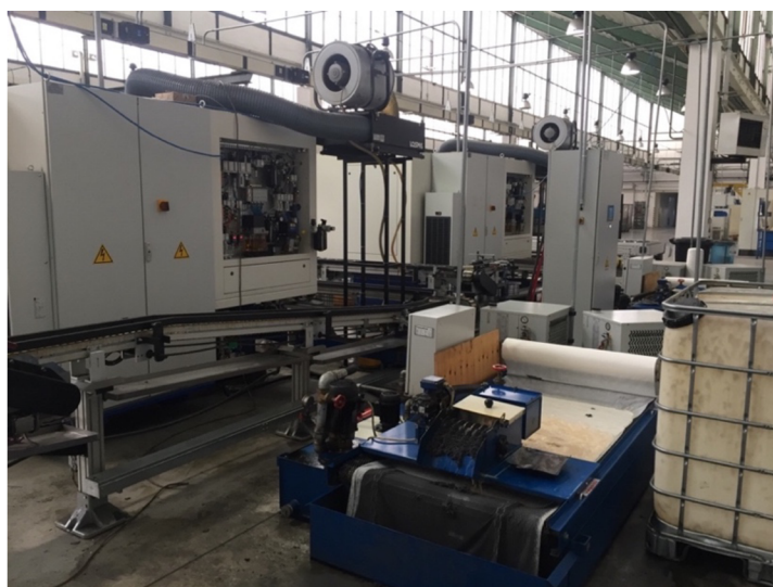
Obrázek 15 Pohled na rozvaděče obou strojů a zařízení pro čištění chladicí emulze, které má každý stroj vlastní.
