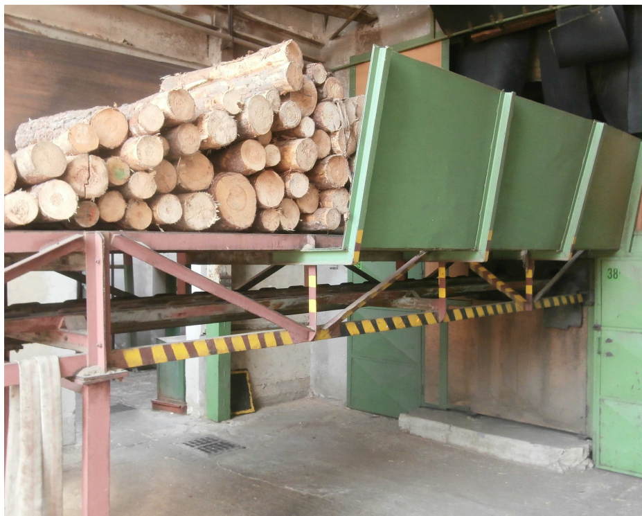
Obrázek 15 - Podchod pod dopravníkem, zajištění před padajícím materiálem
