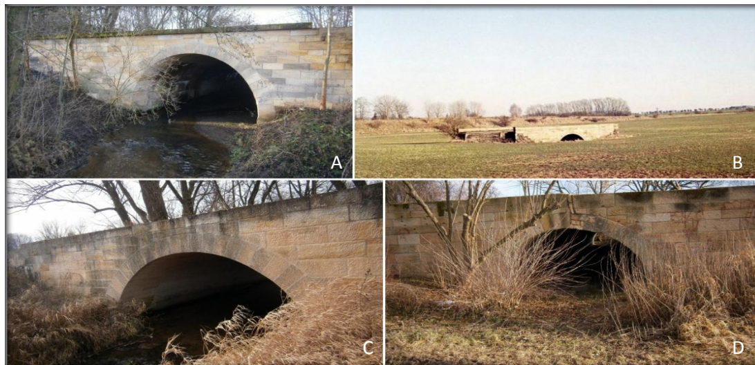
Obrázek 45 A: Most přes Malonínský potok v tělese dálnice, B: Most západního ramena křižovatky, C: Most východního ramena křižovatky, D: Most přes zrušený mlýnský náhon. Foto: Autor, 2013.
