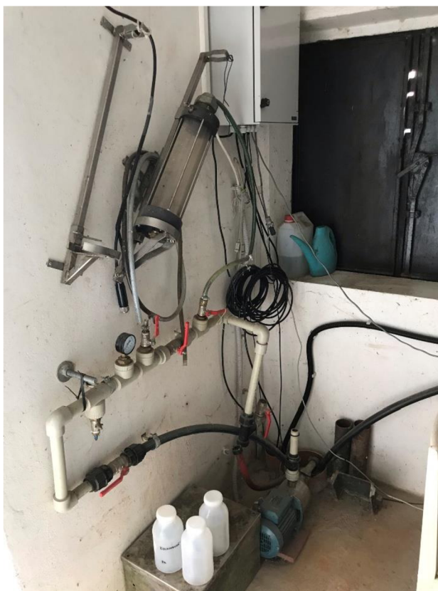
Obr. 5. Již nepoužívaný systém automatického odebírání vzorků plavenin v Židlochovicích
