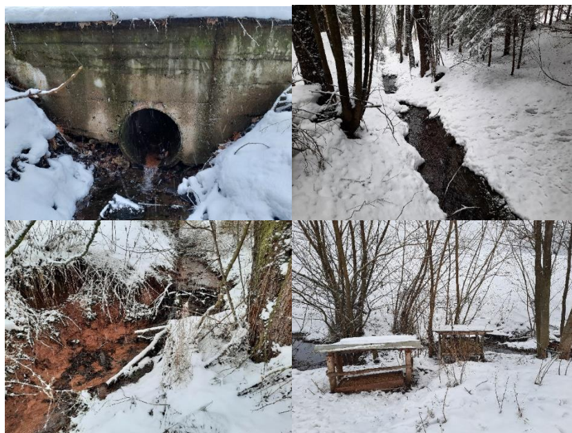
Obr. 46: LP č. 4 č. 5 v zimě – propustek P39-1 (vlevo nahoře), koryto v horním lesním úseku (vpravo nahoře), poškození opevnění vegetací (vlevo dole) a koryto při vtoku do VN 1 (vpravo dole)
