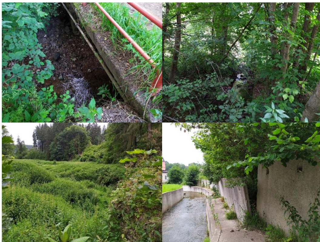
Obr. 41: Kundratický potok – mostek (vlevo nahoře), charakter koryta v blízkosti mostku, nábrežní zídka (vpravo nahoře), pozůstatky vodní nádrže VN6 (vlevo dole), poškozené betonové opevnění při vtoku do Trevosu (vpravo dole)
