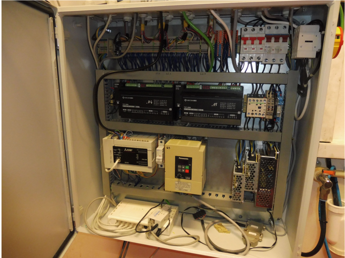
Obrázek 3.13: rozvaděč s rozšiřujícími moduly GECON
