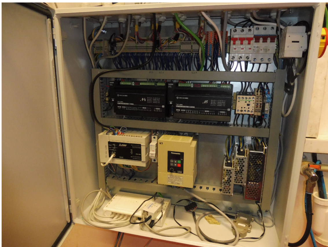
Obrázek 3.13: rozvaděč s rozšiřujícími moduly GECON
