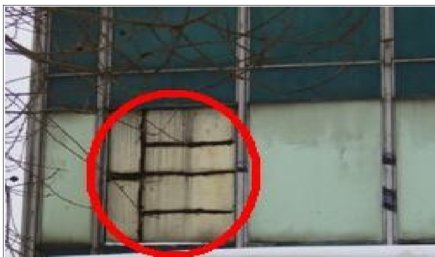
Obr. 9: Poškozený Boletický panel (zdroj: Stavokombinát Invest, ©2017)
