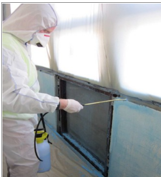
Obr. 32: Penetrace narušeného panelu ( zdroj: Foster Bohemia, ©2012 )
