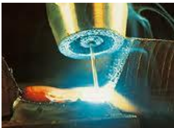
Svařovací hubice a ochranný plyn při svařování elektrickým obloukem tavící se elektrodou (MIG/MAG) [7]
