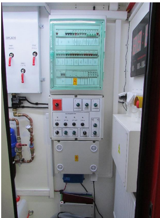
Obrázek č.11: Ovládací a jistící panel elektrické energie SDO-4.
