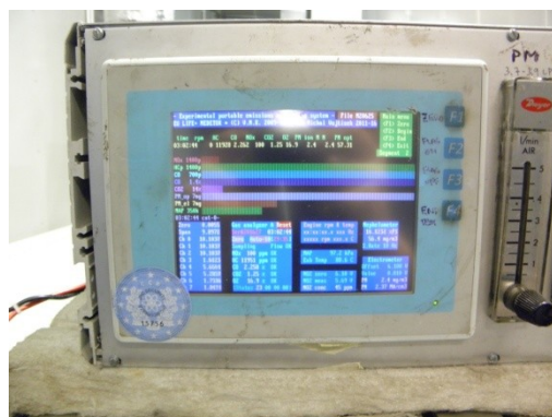
Detail monitoru plynového analyzátoru
