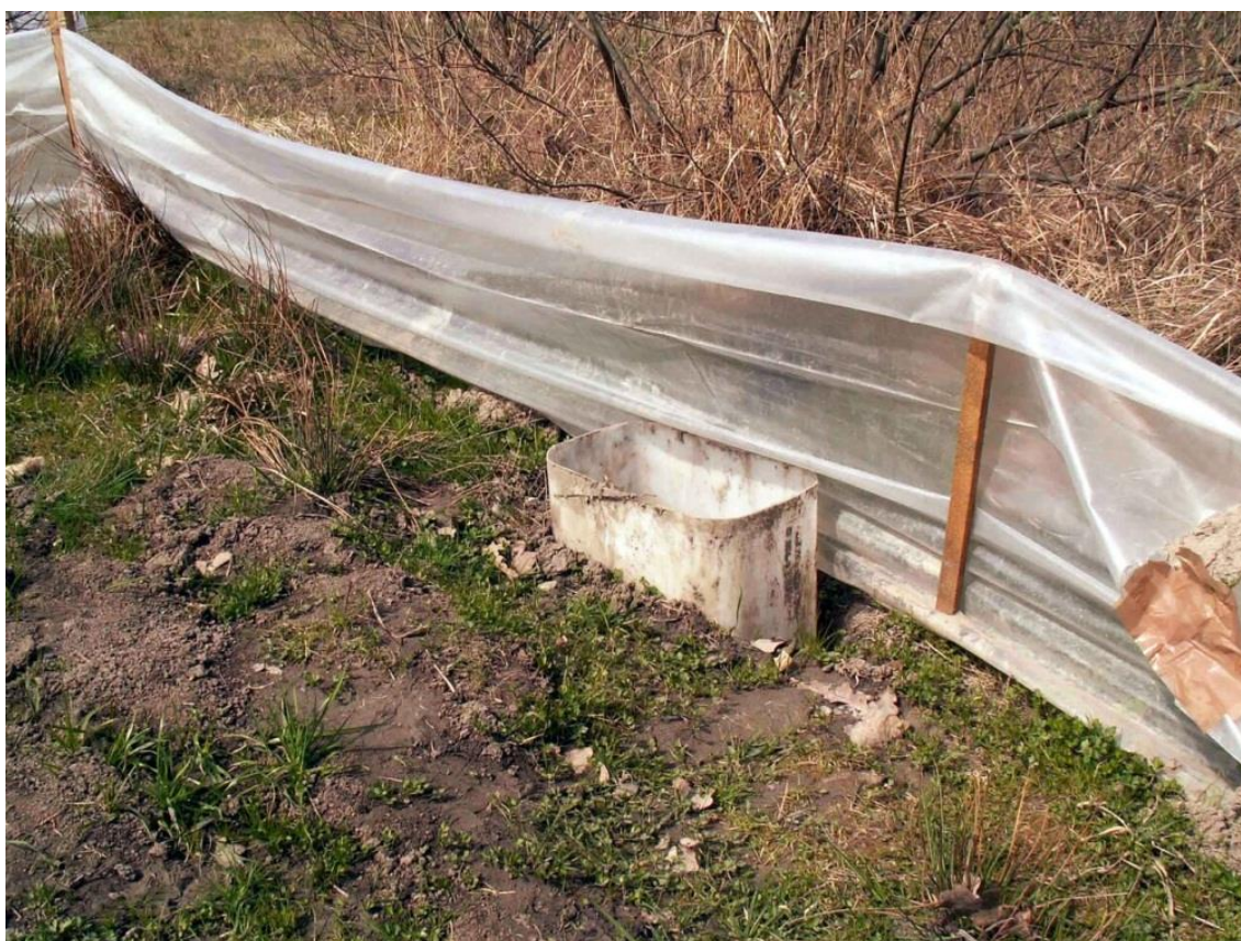
Fotografie 2: Příklad špatné instalace dočasné bariéry a odchyťové nádoby. Odchyťová nádoba nemá okraj na úrovni okolí, spodní část fólie není přihrnutá, bariéra je plně prostupná. ©Roman Rozínek
