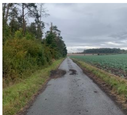
Obr. č. 19: Poškození na HCZS7
