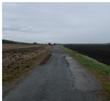
Obr. č. 13: poškození a opravy na HCZS3
