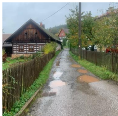
Obr. č. 56: Poškozené části vozovky HC3
