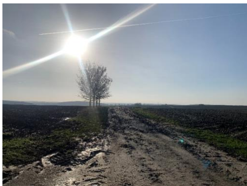
Obr. č. 31: Neodpovídající povrch na posledních 50 m cesty C2.3
