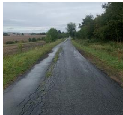
Obr. č. 15: Poškození povrchu vozovky HCZS4
