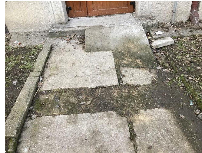
Obr. 68 - Vstup z vnitrobloku do budovy. Betonový chodník v nevhovujícím technickém stavu (foto, autor 2017)
