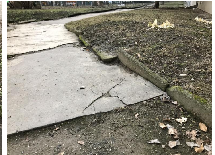
Obr. 69 - Cesty ve vnitrobloku v nevhovujícím technickém stavu (foto: autor, 2017)
