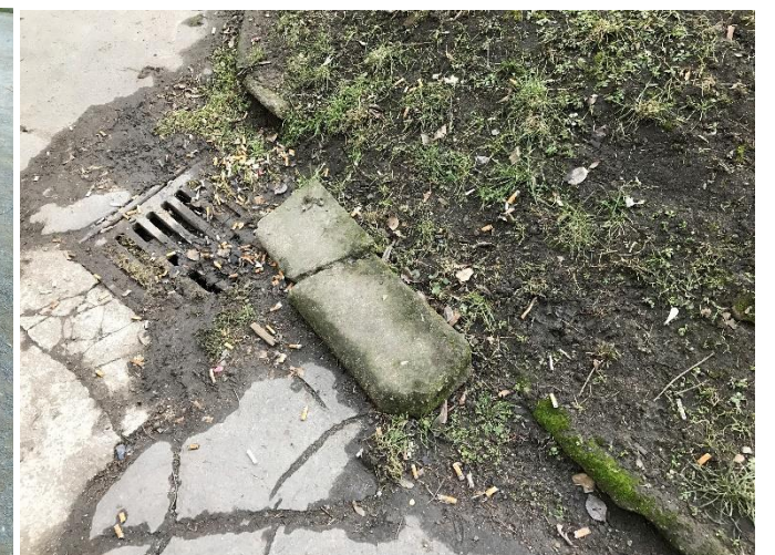
Obr. 73 - Současný stav obrubníků ve vnitrobloku (foto: autor, 2017)
