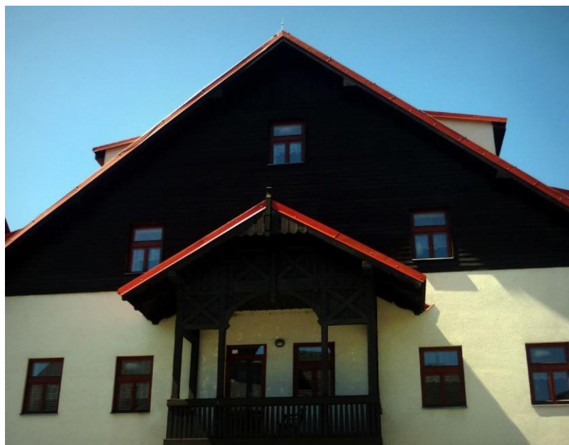
Fotografie č. 10 - Nevhodně zvolený balkon (autorská fotografie)
