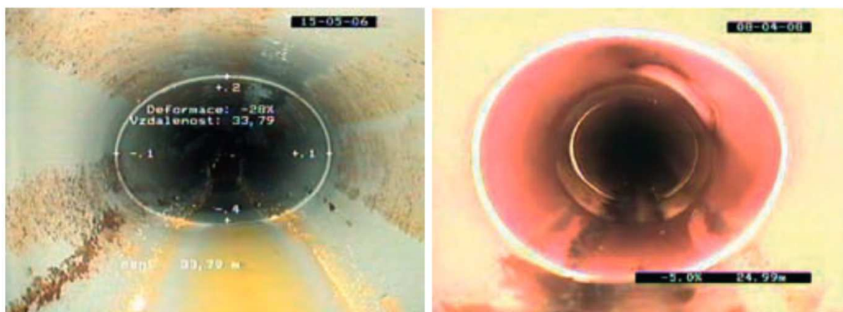
Obr. 6: Ovalitní deformace plastových kanalizačních trub [10]
