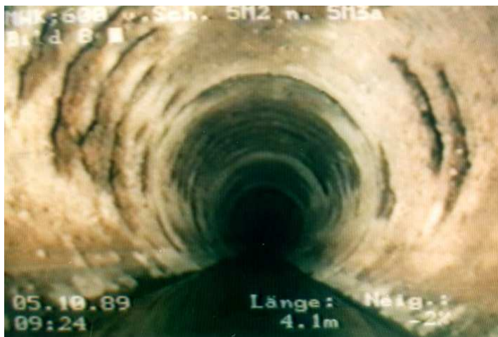
Obr. 12: Koroze na vnitřním povrchu betonového potrubí [30]
