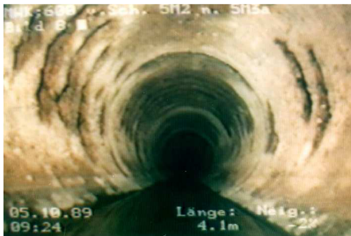
Obr. 12: Koroze na vnitřním povrchu betonového potrubí [30]
