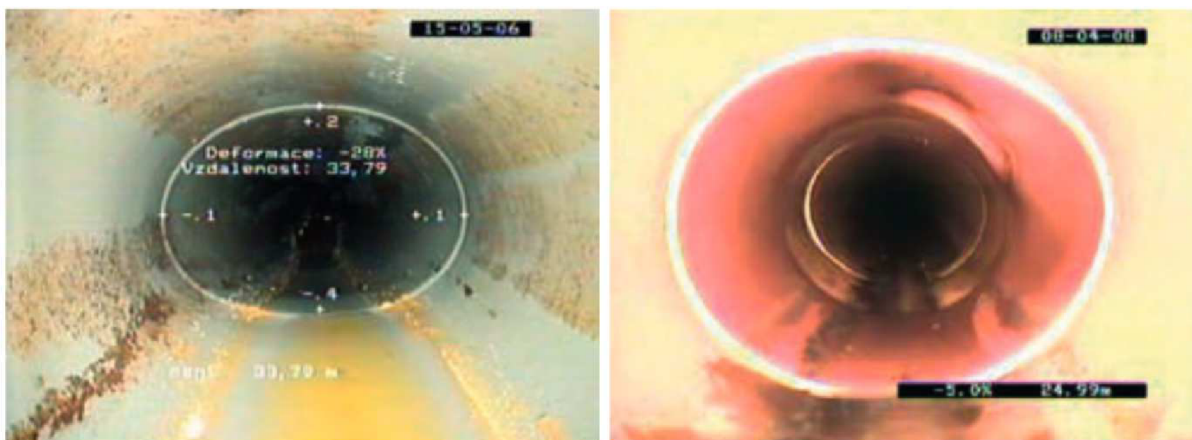
Obr. 6: Ovalitní deformace plastových kanalizačních trub [10]
