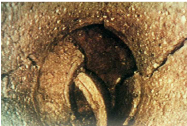
Obr. 18: Zborcení kanalizačního potrubí [31]
