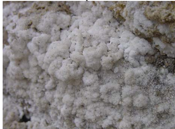
Obr. 42: Výkvěty solí na bloku pískovce z podezdívky kavárny Mahler (Horní náměstí 11)
