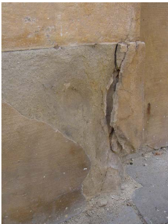
Obr. 51: Horní náměstí 11 (Krajinská lékárna) – klínovité odlamování působením mrazu (frost wedging)
