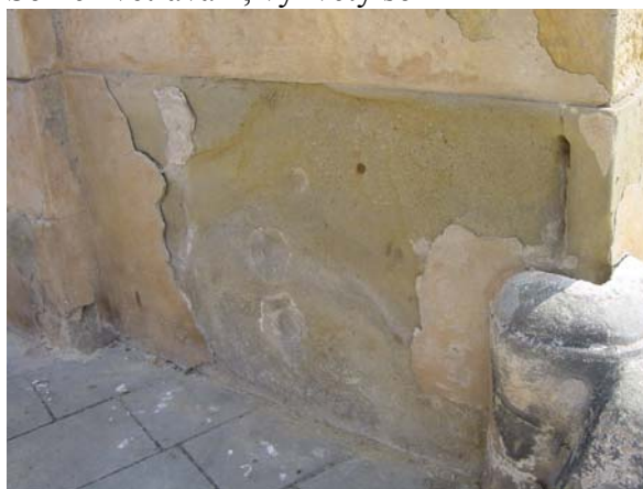
Obr. 48: Krajinská lékárna, Horní náměstí 10 – odlupování krust, výkvěty solí
