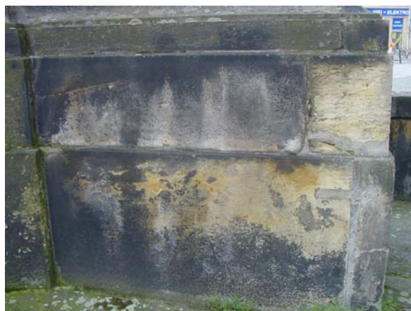
Obr. 70: Morový sloup, Dolní náměstí - biokoroze
