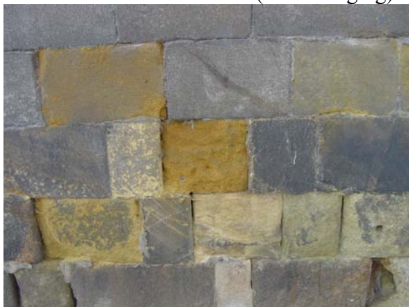
Obr. 65: Správní archiv Armády ČR. Nám. Republiky 4 (býv. Jezuitská kolej). Diferenciální zvětrávání různých druhů pískovce
