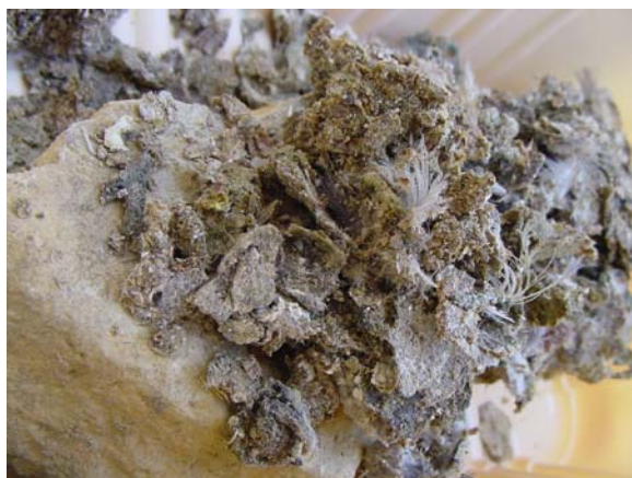
Obr. 56: Degradace působením holubího trusu
