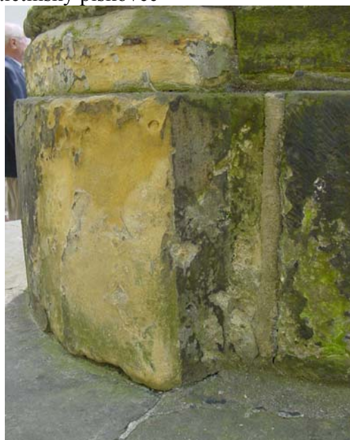
Obr. 68: Žerotínovo náměstí – podstavec sochy sv. Floriána - biokoroze
