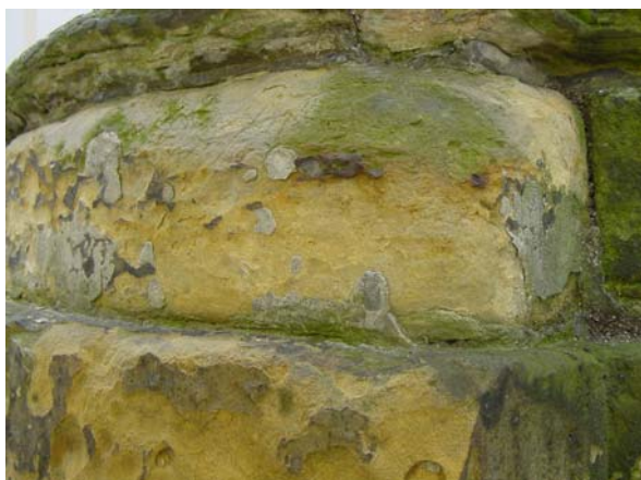
Obr. 69: Žerotínovo náměstí – podstavec sochy sv. Floriána - biokoroze
