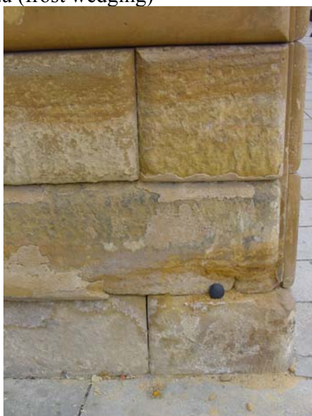
Obr. 53: Horní náměstí č.p.11 (Café Mahler), Olomouc - vzorek VS4. Zvýšená intenzita mrazového poškození v bloku s výraznější vrstevnatou stavbou
