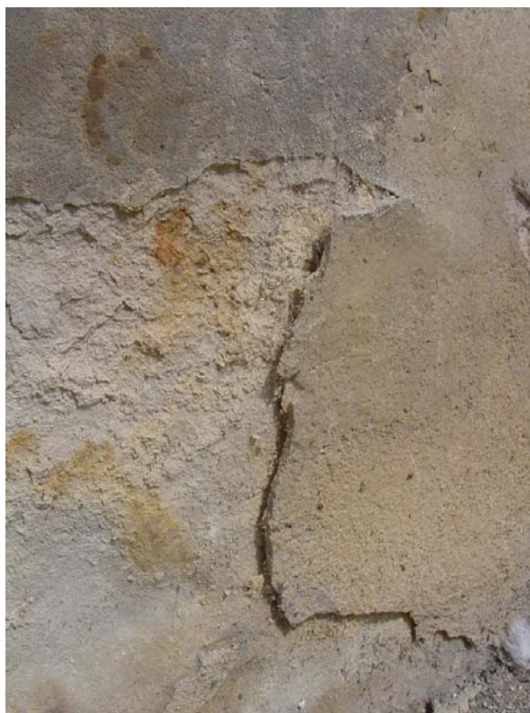
Obr. 52: Šupinovitě odlupování cementového potěru, pod ním práškovitý rozpad pískovce. Budova radnice, Horní náměstí 583
