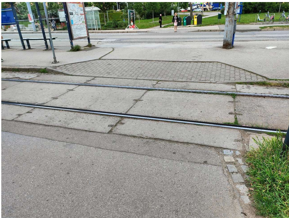
Obr. 9 Chybějící varovný pás a signální pás přechodu přes tramvajový pás
