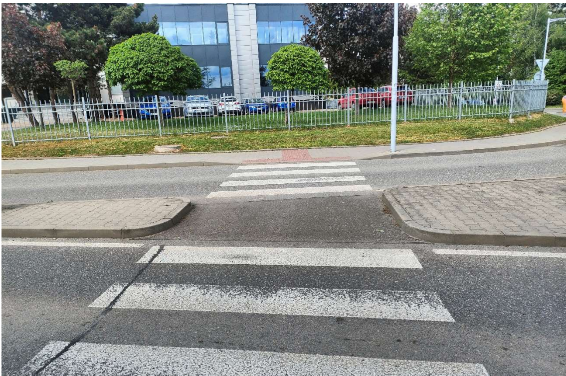
Obr. 16 Chybějící hmatové úpravy na dělicím ostrůvku přechodu pro chodce
