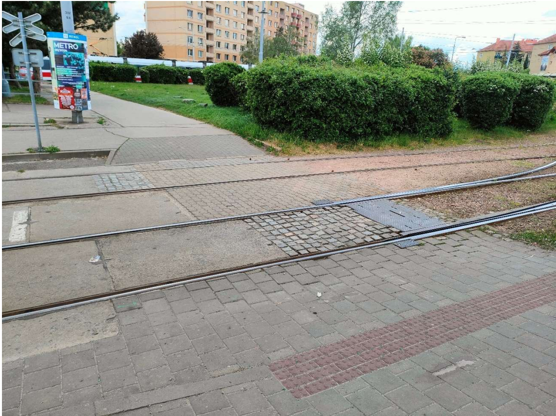
Obr. 13 Porucha povrchu, chybějící na jedné straně varovný pás a na obou stranách signální pás přechodu přes tramvajový pás
