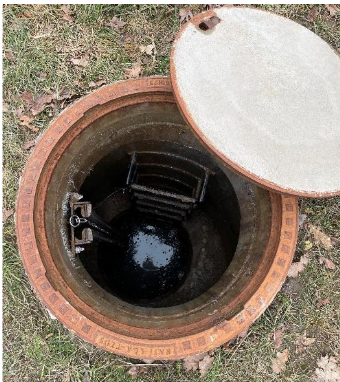
Obrázek 16 Vstupní šachta (ČOV Závada)
