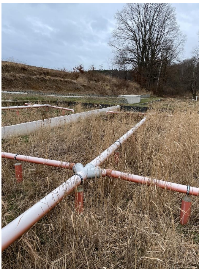
Obrázek 20 Potrubí na prvním filtru (ČOV Závada)
