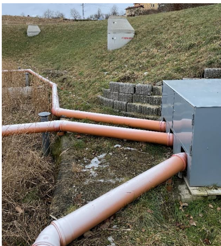
Obrázek 19 Větvení potrubí na filtrační pole (ČOV Závada)
