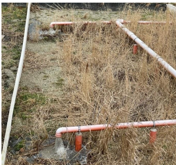
Obrázek 21 Nesprávné dávkování na první filtr (ČOV Závada)
