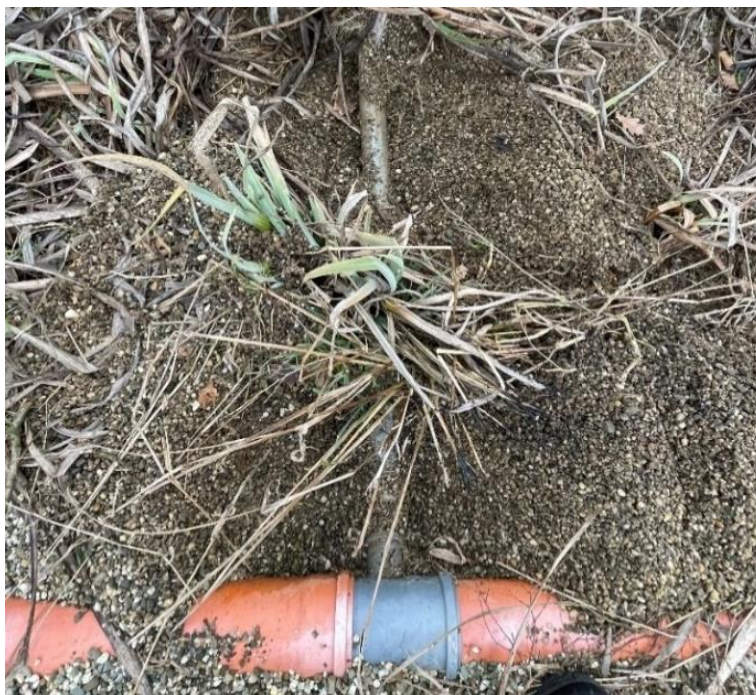
Obrázek 27 Nesprávné uložení potrubí (ČOV Závada)
