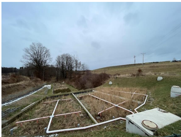
Obrázek 18 Pohled na první filtr a distribuční šachtu s rozvodným potrubím (ČOV Závada)
