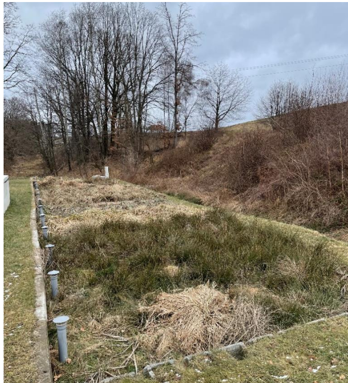
Obrázek 26 Druhé filtrační pole (ČOV Závada)
