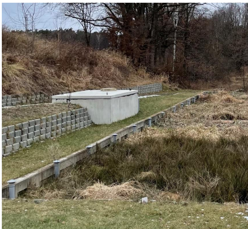
Obrázek 24 Distribuční šachta na druhém filtru (ČOV Závada)
