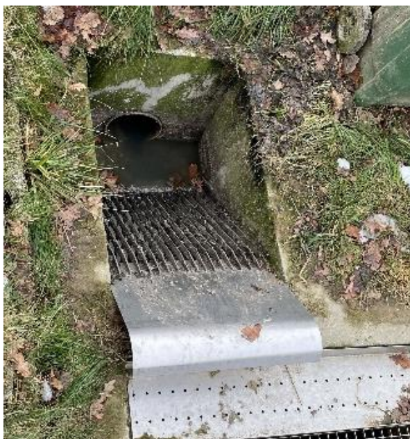
Obrázek 14 Správné uložení česlí na vstupu (ČOV Závada)
