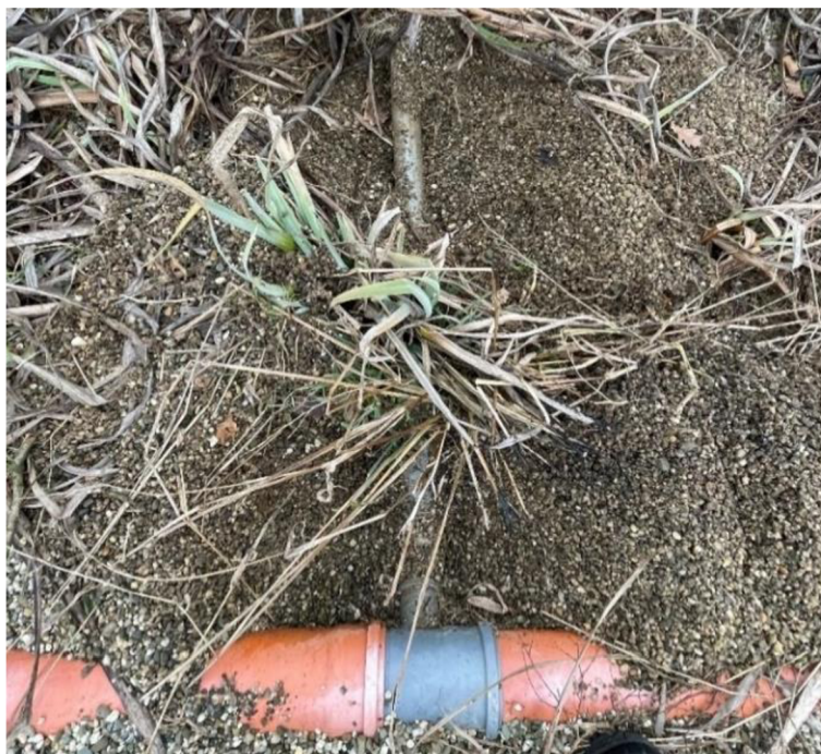
Obrázek 27 Nesprávné uložení potrubí (ČOV Závada)
