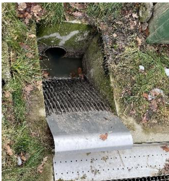
Obrázek 14 Správné uložení česlí na vstupu (ČOV Závada)
