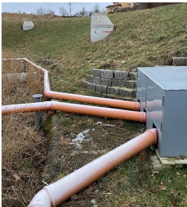
Obrázek 19 Větvení potrubí na filtrační pole (ČOV Závada)
