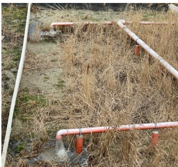
Obrázek 21 Nesprávné dávkování na první filtr (ČOV Závada)
