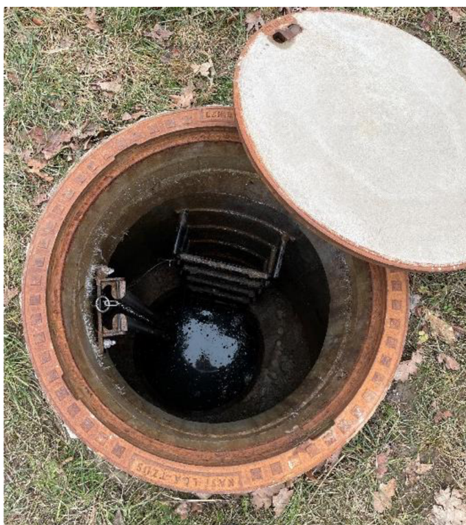
Obrázek 16 Vstupní šachta (ČOV Závada)
