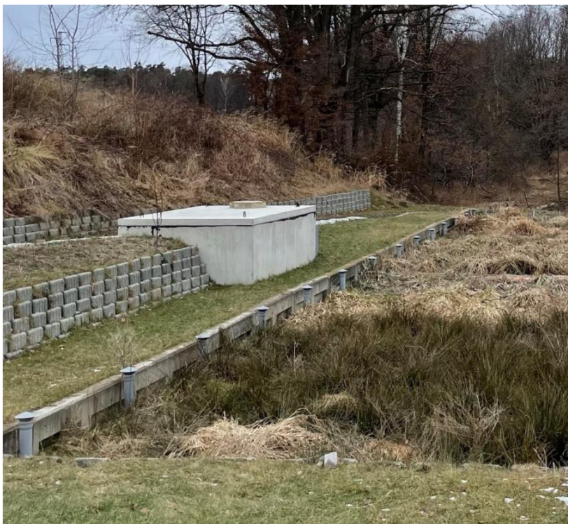
Obrázek 24 Distribuční šachta na druhém filtru (ČOV Závada)
