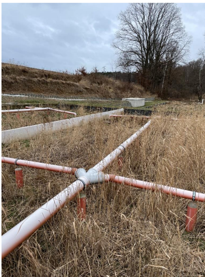
Obrázek 20 Potrubí na prvním filtru (ČOV Závada)
