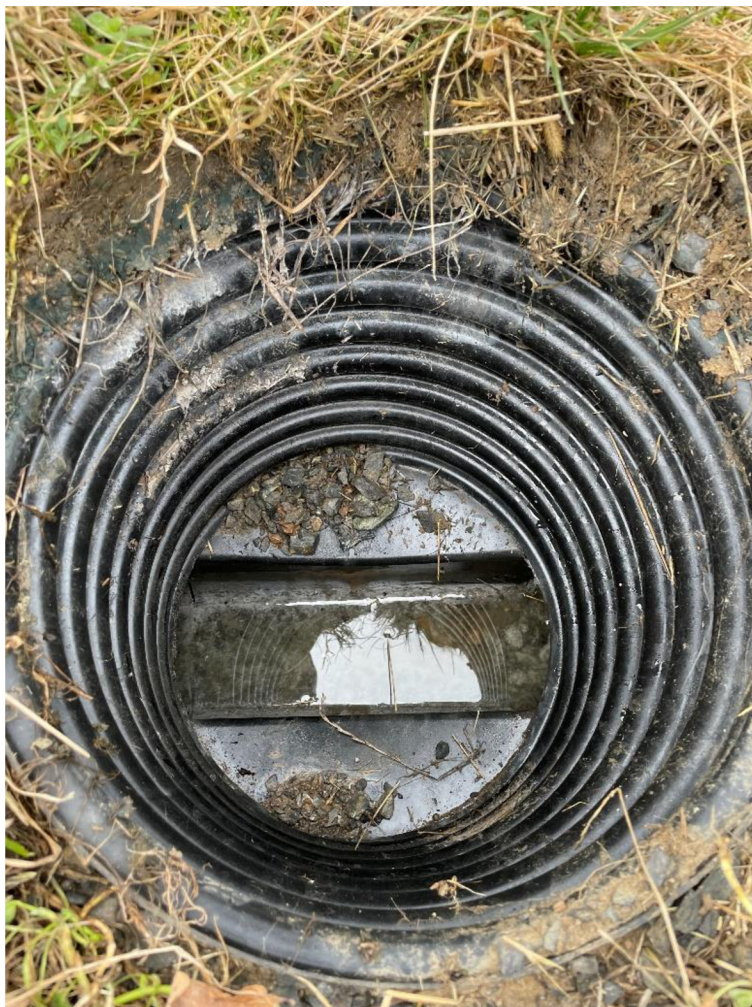
Obrázek 23 Revizní šachta na výstupu z prvního filtru (ČOV Závada)
