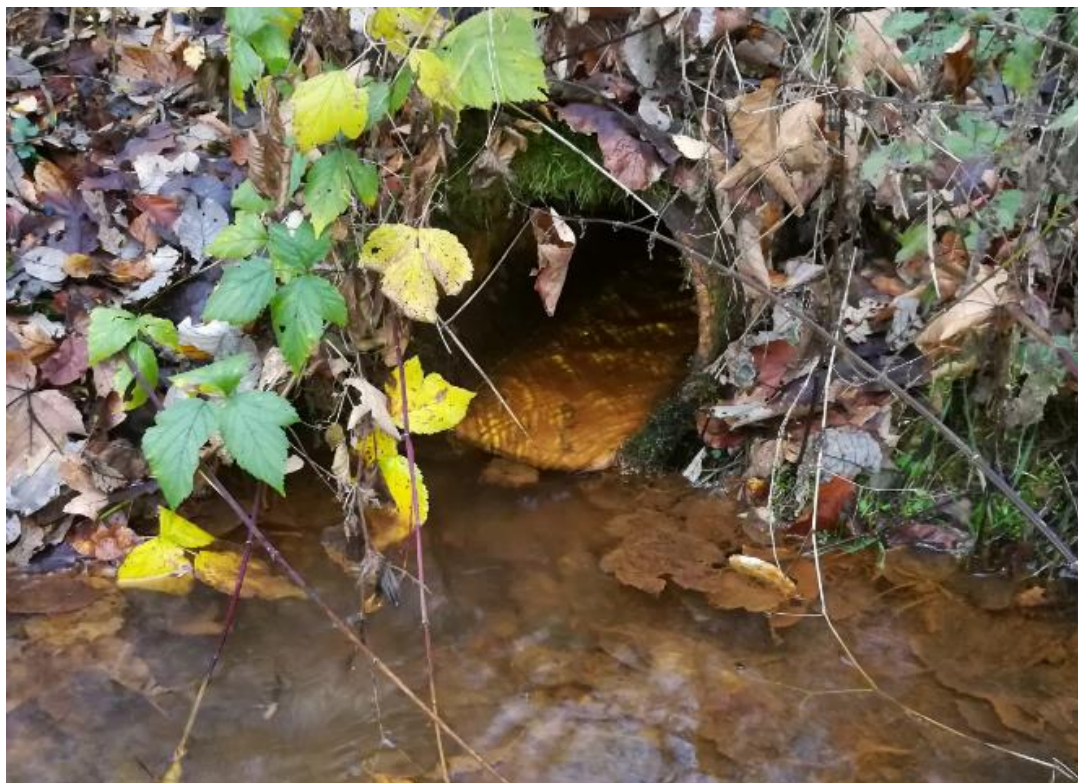
Obrázek 7: Ústí odvodňovací štoly Popov, ze které se zachovalo pouze kovové potrubí (AUTOR, 2019).
